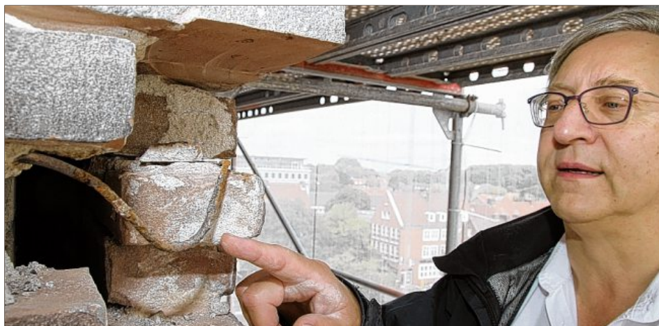
Pastor Christoph Jebens zeigt auf Schäden im Mauerwerk.
