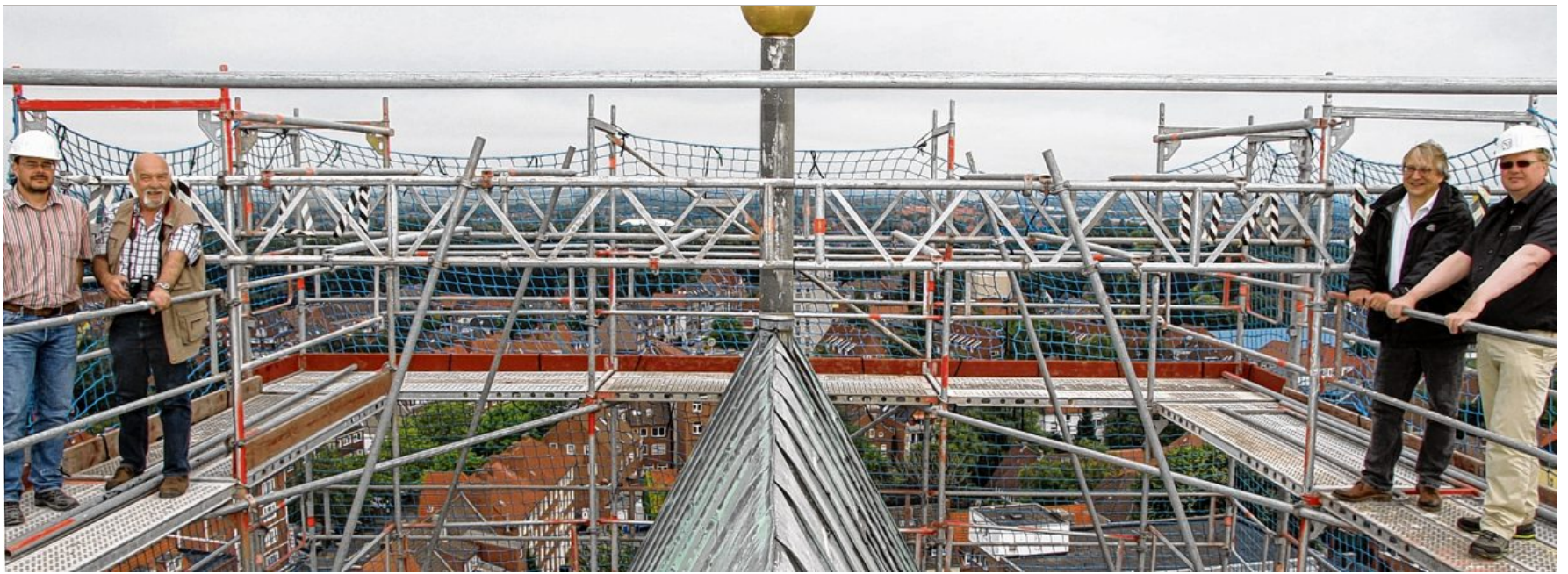
Die Besichtigung der Turmspitze: Der Architekt Christian Staudt (von links) und Hans-Georg Hunger vom Bauausschuss der Martin-Luther-Kirche verschafften sich mit Pastor Christoph Jebens und Volkmar Janssen (Vorsitzender des Bauausschusses) ein Bild vom Zustand des Daches. BILDER: PÄSCHEL
