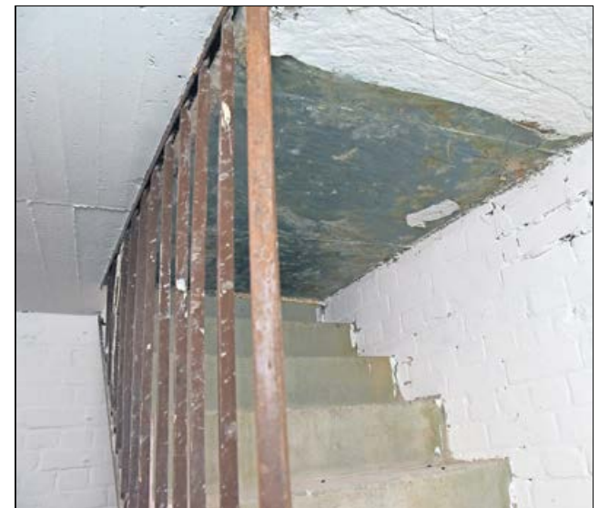
Treppe ins Nichts: Hier ging es früher hoch in die Küsterwohnung.
