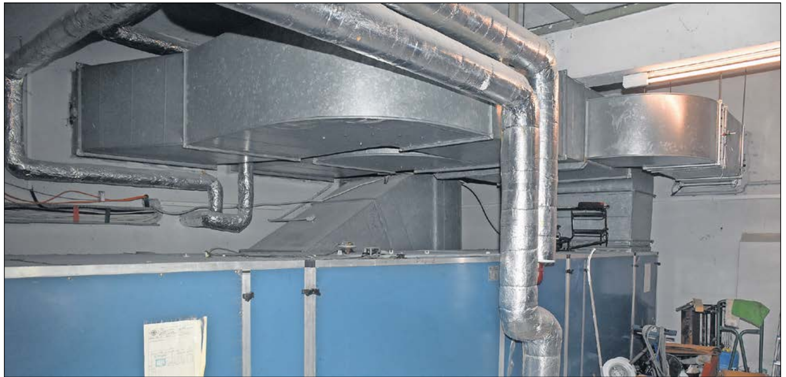
Eigentlich nur das Transportmittel: Zur Heizungsanlage der Martin-Luther-Kirche gehört auch das große Gebläse, das die warme Luft über ein Schachtsystem in der Kirche verteilt.
